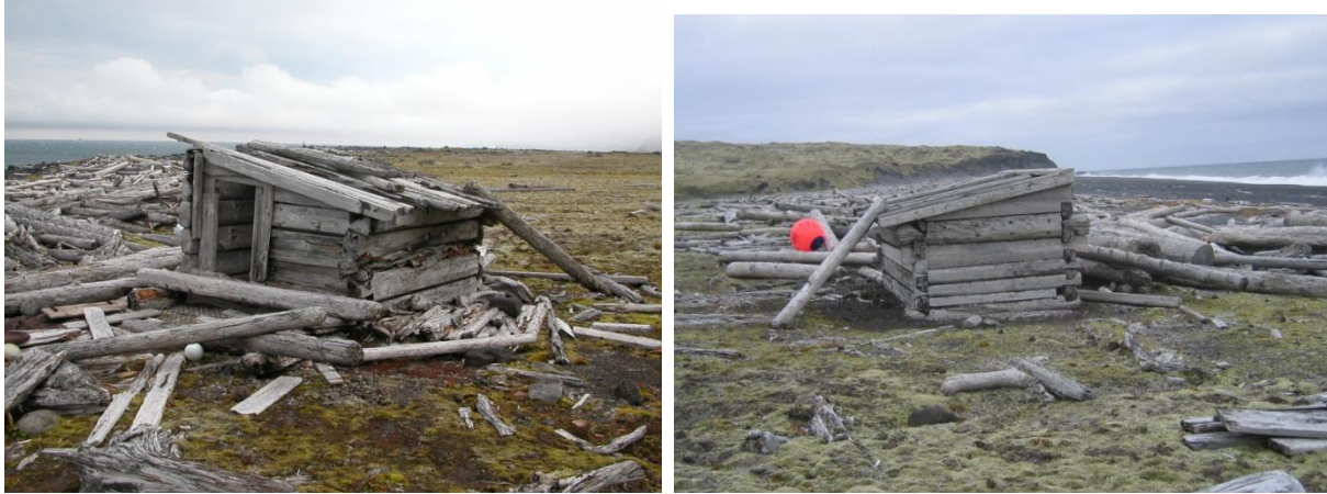
Olsbu. T.v.: Før restaureringen (Foto: T. Haraldstad 2004). T.h.: Etter restaureringen. (Foto: Susan Barr 2006).
