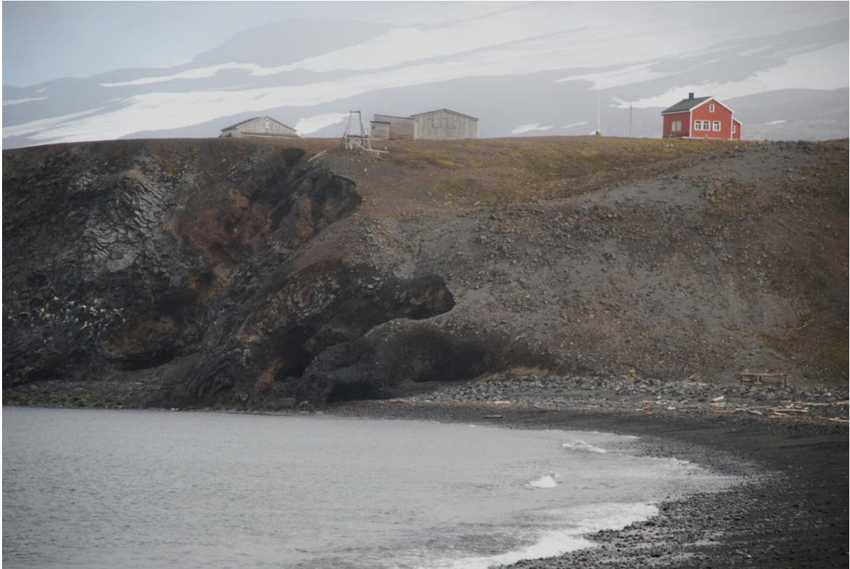
Erosjonens innvirkning ved et fredet taubaneanlegg (2008) over og kulturminner i Maria Muschbukta (2013) under
