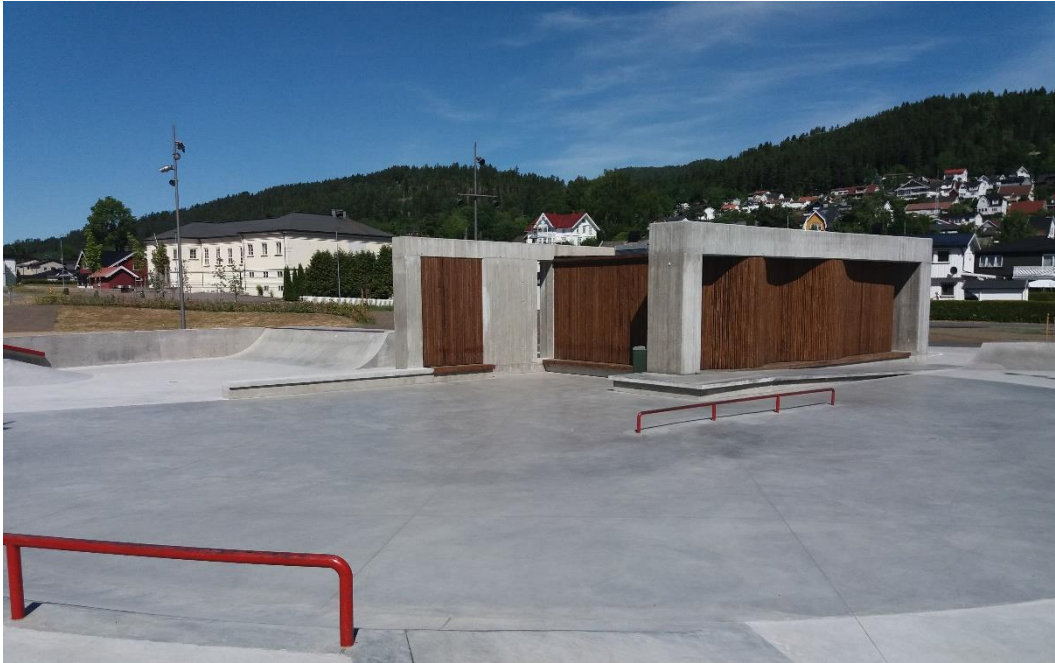
Figur 7-2 Pumpestasjon for overvatn i nedsenka skatepark med sittebenker og klatrevegg. Krokstadelva i Drammen kommune, NVE / Rune Bratlie.
